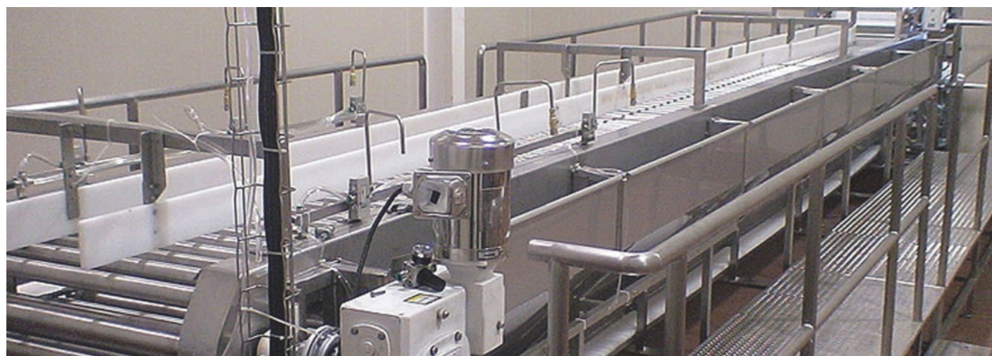
Fabricación, montaje e instalación de equipo de proceso (tanques, reactores, transportadores). Instalación de sistema de tuberías (vapor, condensados, agua, aire y drenaje).
